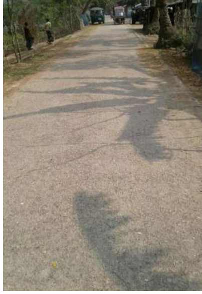
চিত্র ২৭- বড়বগি ইউনিয়ন সড়কের মেরামত পরবর্তী অবস্থা
